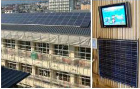
교실 지붕위에 설치한 태양광 발전 판 넬. 북도에는 실물 크기의 판넬 전시
